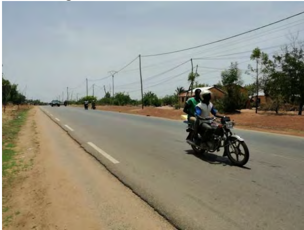
Photo 2: Etat des routes bitumées (RN1 à Nassablé)
