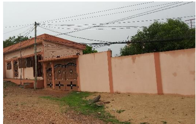
Photo 39: Passage de fils électriques le long d'un mur
