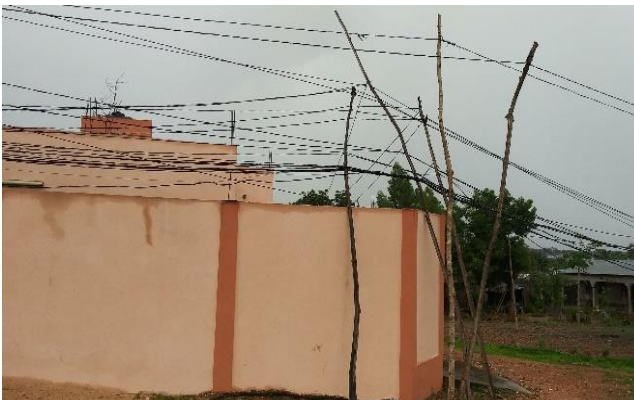
Photo 38: Passage de fils électriques au carrefour de l'école
